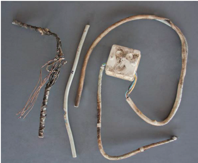
Figur 1: Figuren viser en kabel med omfattende gnageskader. Det har her oppstått kortslutning og sterk varme.
