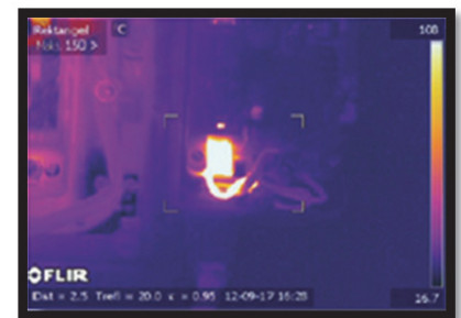
Termogram som viser temperatur i koblingsboks.
